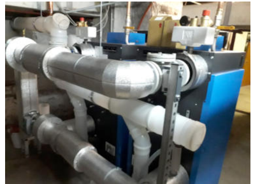
Die neue Heizungsanlage, sieht kompliziert aus
